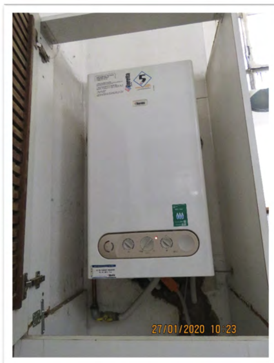
Particolare della caldaia murale e delle finestre piano marciapiedi su via Falloppio.
