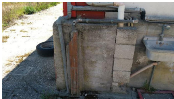
Impianti (esterno Fabbricato)_02
