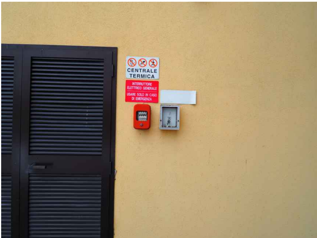
Piancavallo, via Barcis – L'area di manovra con gli ingressi al garage, alla cabina elettrica e al gruppo elettrogeno, sotto l'interruttore generale.
