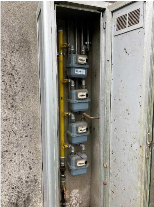
Foto n. 19: contattori posti a nord
