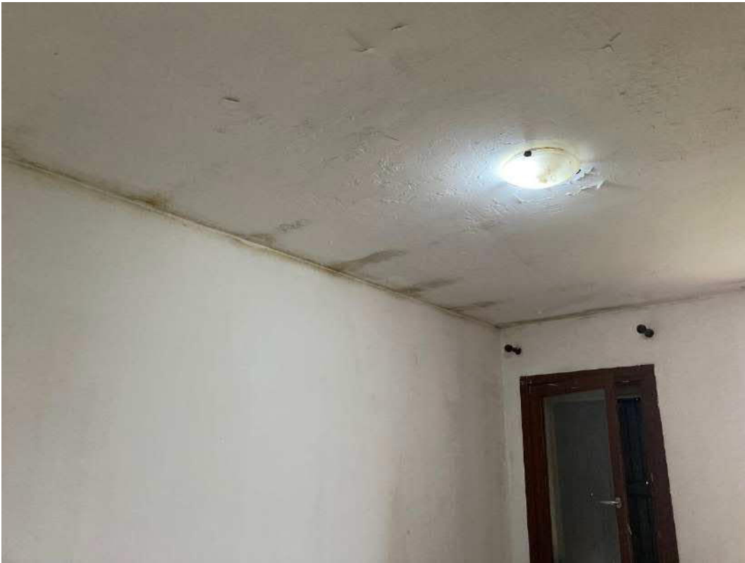
Foto n. 23: camera a nord-ovest (umidità)
