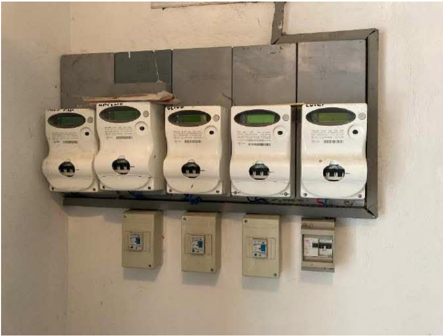
Foto n. 18: contatori posti nel vano scala condominiale
