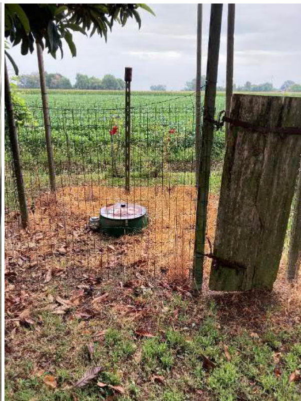
Foto n. 20: bombolone interrato posto ad est
