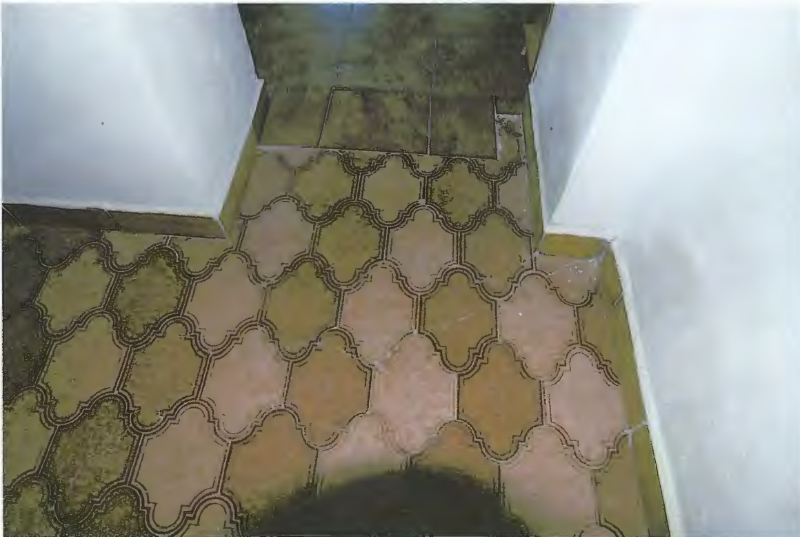
12) Particolare pavimento fessurato del corridoio – vano 3;
