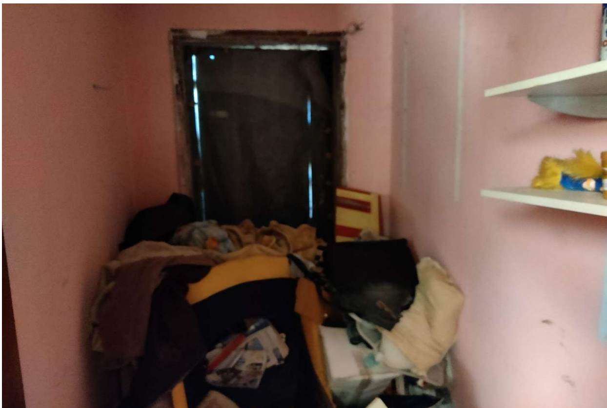
Foto n. 10 - Ripostiglio sulla sinistra nella zona giorno: in evidenza la mancanza del serramento della porta che da sull'esterno.
