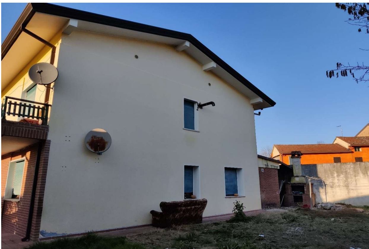
Foto n. 30 - Elementi delle lattoneria in distacco e sistema di ricezione satellitare con parabola esterna.
