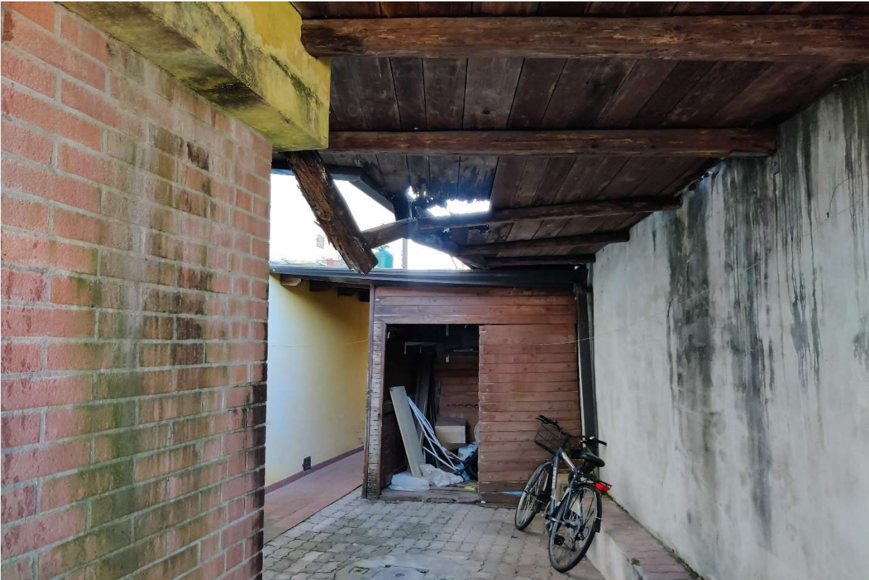
Foto n. 28 - Porzione di copertura e manufatti in legno ad uso ricovero attrezzi da demolire.
