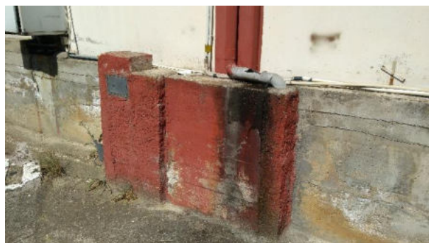
Impianti (esterno Fabbricato)_02
