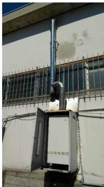
Caldaia a gas_02
