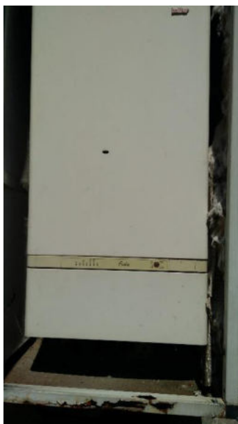
Caldaia a gas_01
