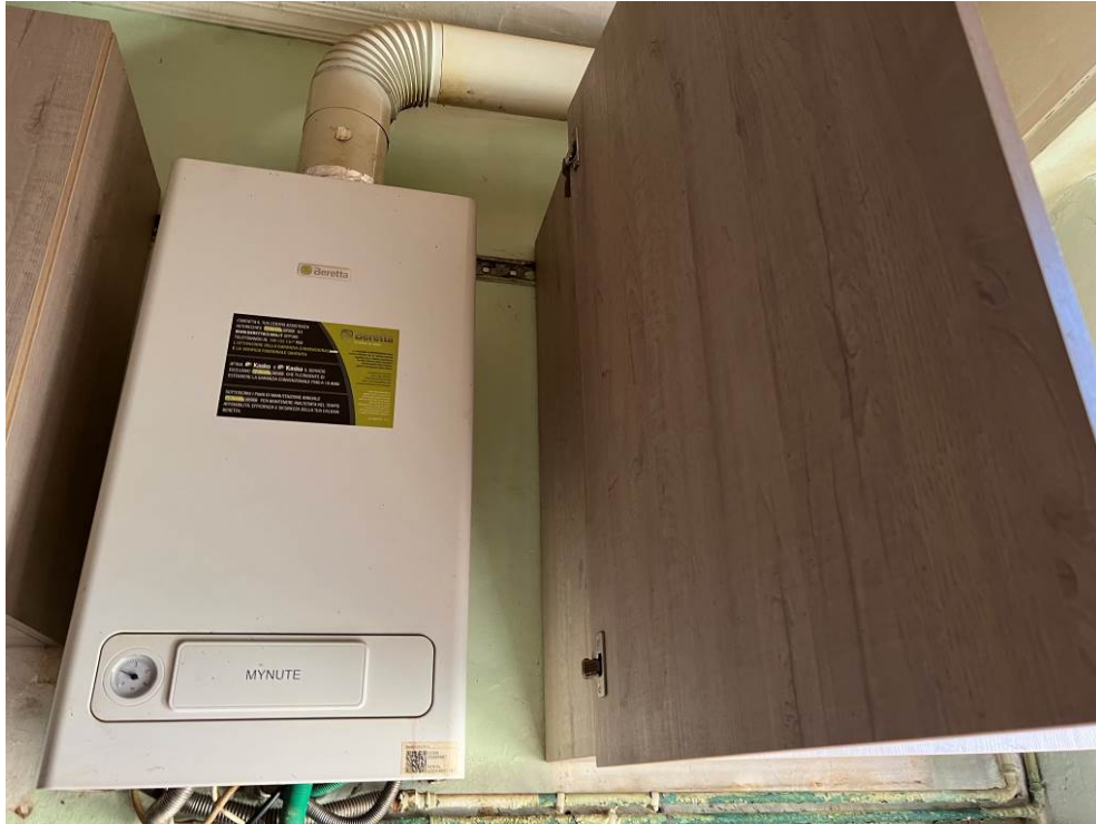
Fotografia n. 12 – Particolare della caldaia a gas presente nel locale cucina
