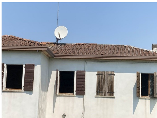
Particolare del vetusto/degradato manto di copertura
