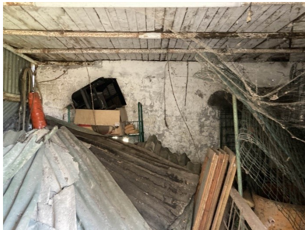
particolare ripostiglio con ingresso abusivo non sanabile
