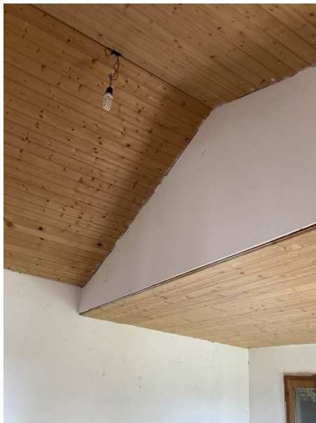
Ulteriore particolare nella camera con controsoffitti da sistemare
