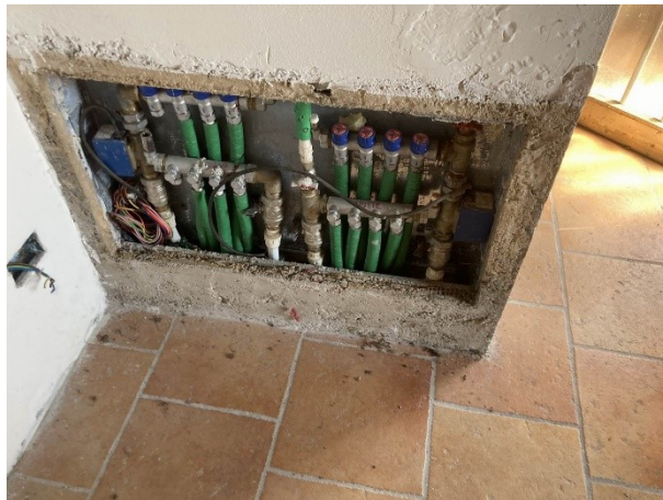
particolare collettore dell'impianto termico
