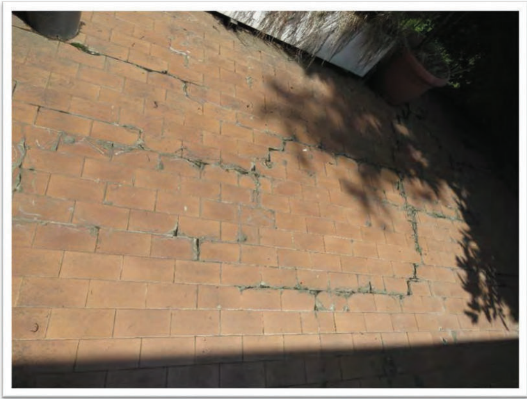
Particolari di degrado del terrazzo.
