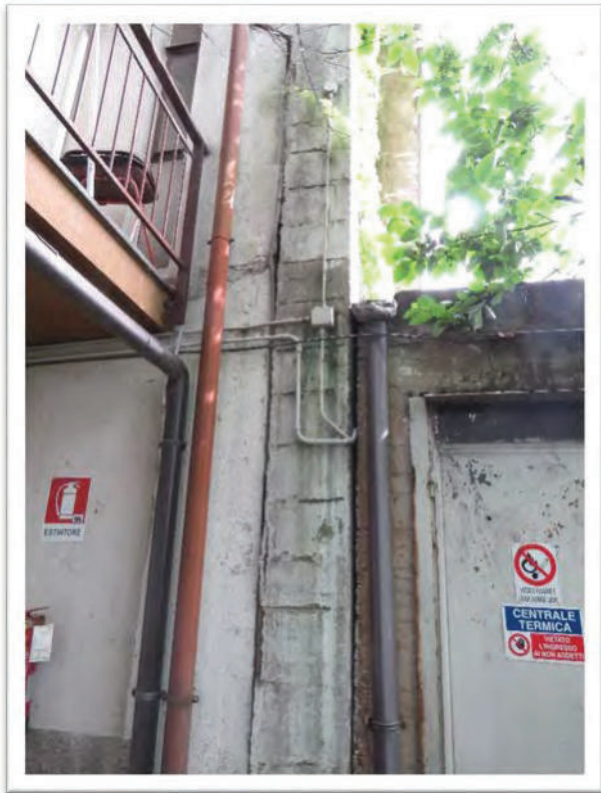
Particolari di degrado.
