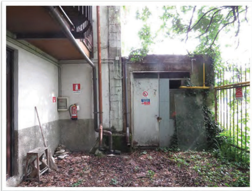
Il locale caldaia.
