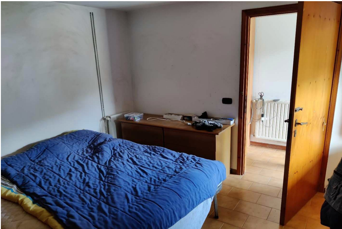
Foto n. 20 – Camera. In evidenza l'impianto termico fuoritaccia – non funzionante.
