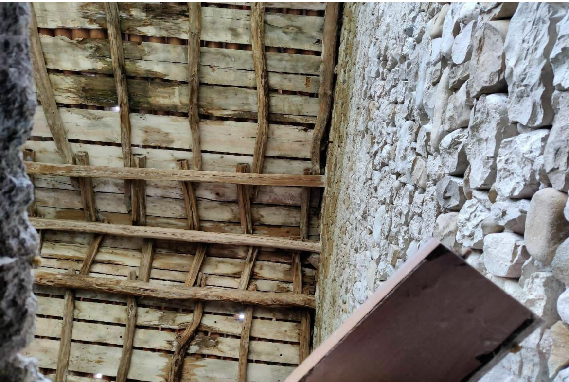
Foto n. 28 – Piano primo deposito, visto dal foro sulla pavimentazione che permette la salita mediante scala a pioli. In evidenza orditure di travi del tetto in legno, con tavolati grezzi di sottotetto.
