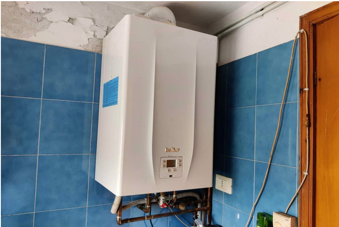
Foto n. 26 – Caldaia di fabbricazione "Baltur" a gas metano – non funzionante. In evidenza stacchi di intonaci e tinte.
