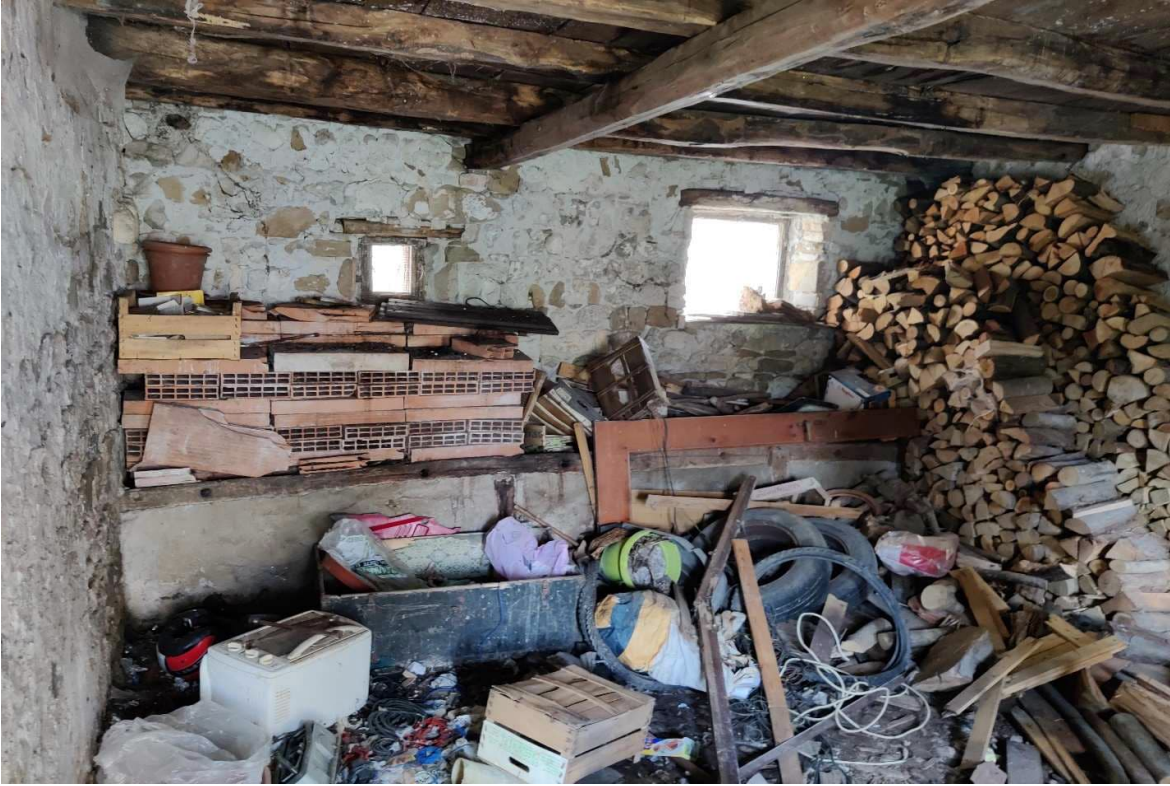
Foto n. 27 – Interno deposito al piano terra. In evidenza i fori.
