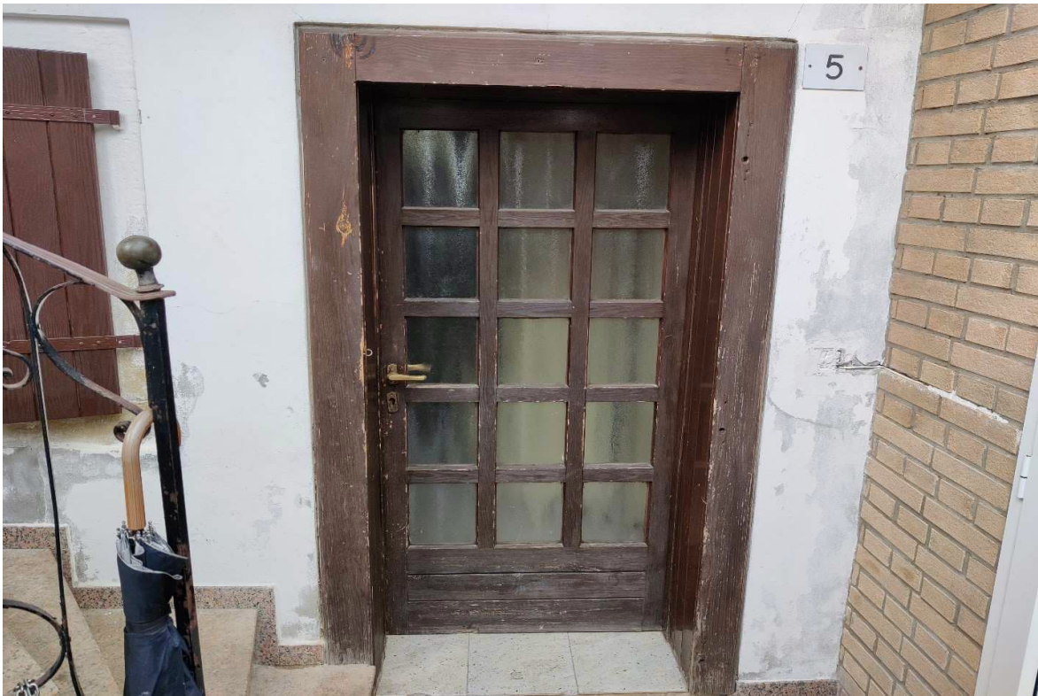
Foto n. 8 – Portoncino d'ingresso al piano terra. In evidenza la carenza di manutenzione.
