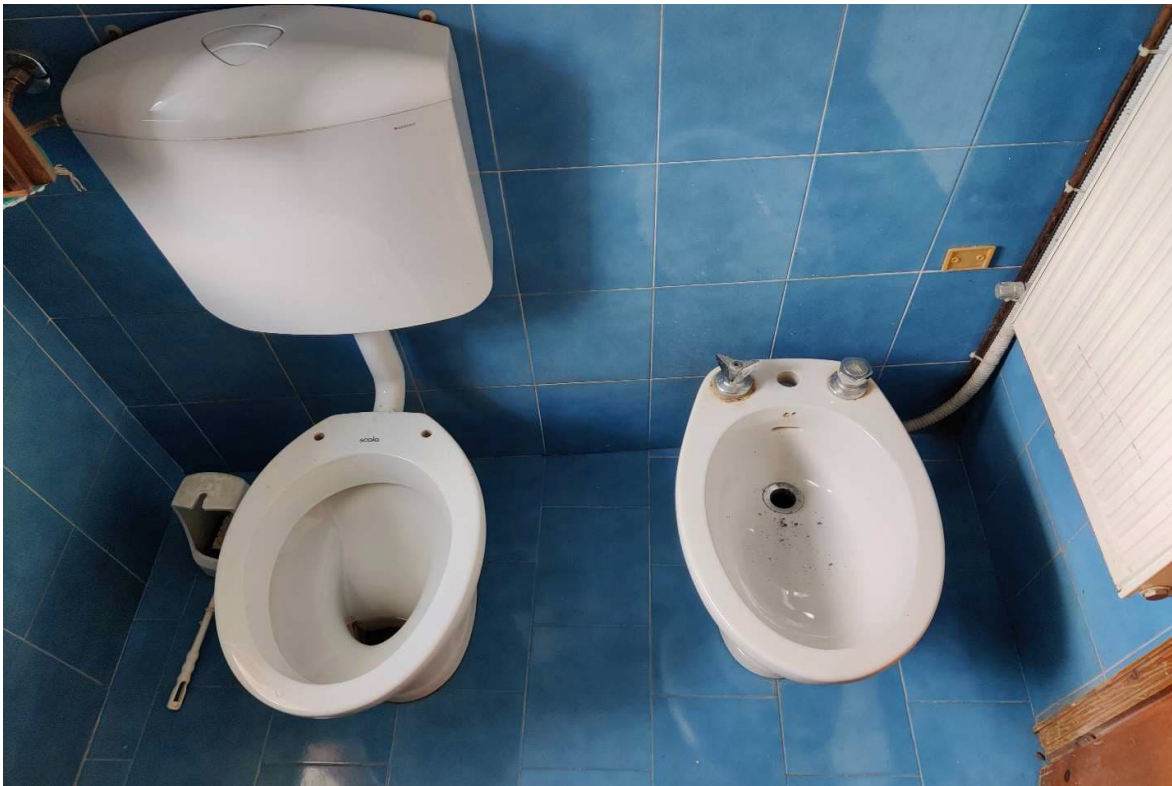
Foto n. 24 – Sanitari bagno al piano primo. In evidenza il degrado e la carenza di manutenzione. Tubazioni dell'impianto termico – non funzionante – fuori traccia.
