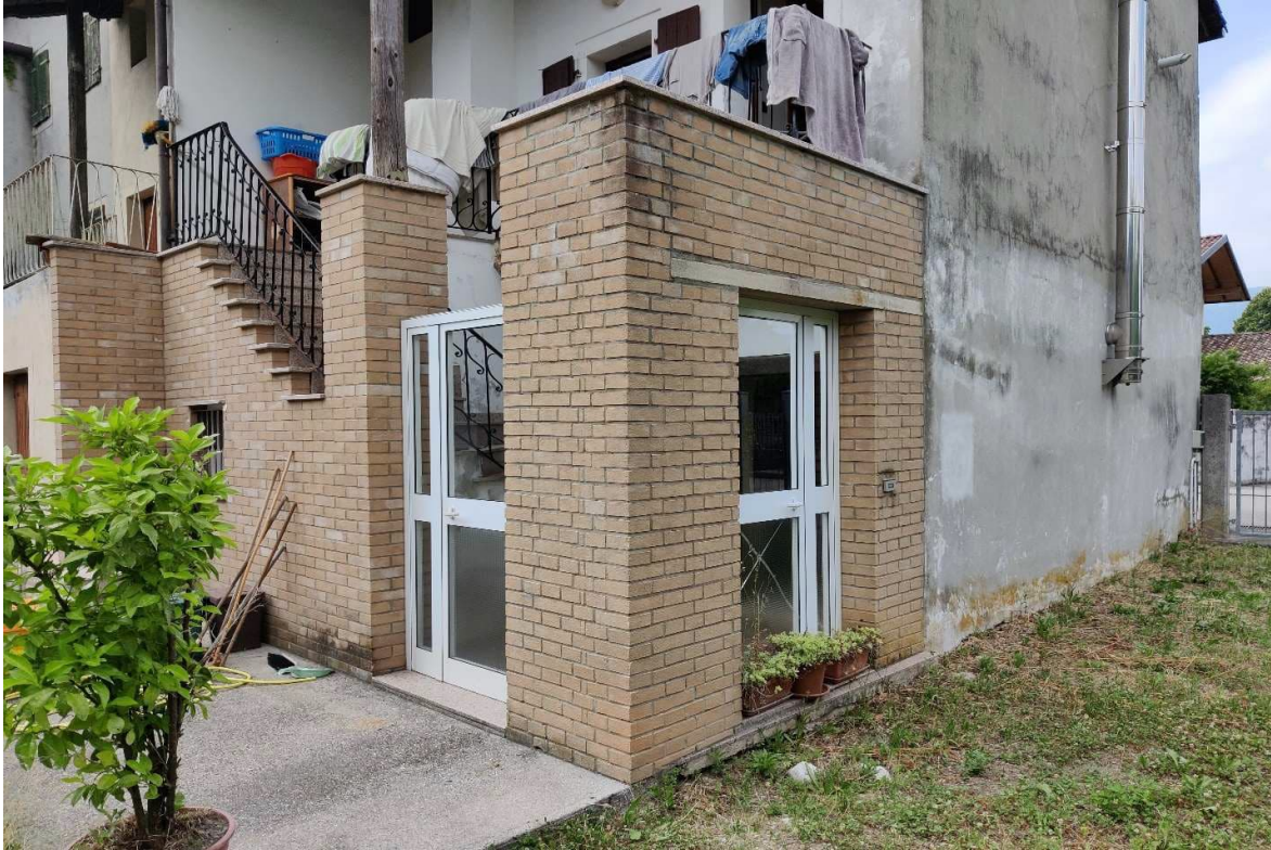
Foto n. 7 – Manufatto in mattoni non autorizzato, dove sono stati inseriti n. 2 portoncini d'ingresso. Sulla destra, canna fumaria in acciaio non autorizzata.
