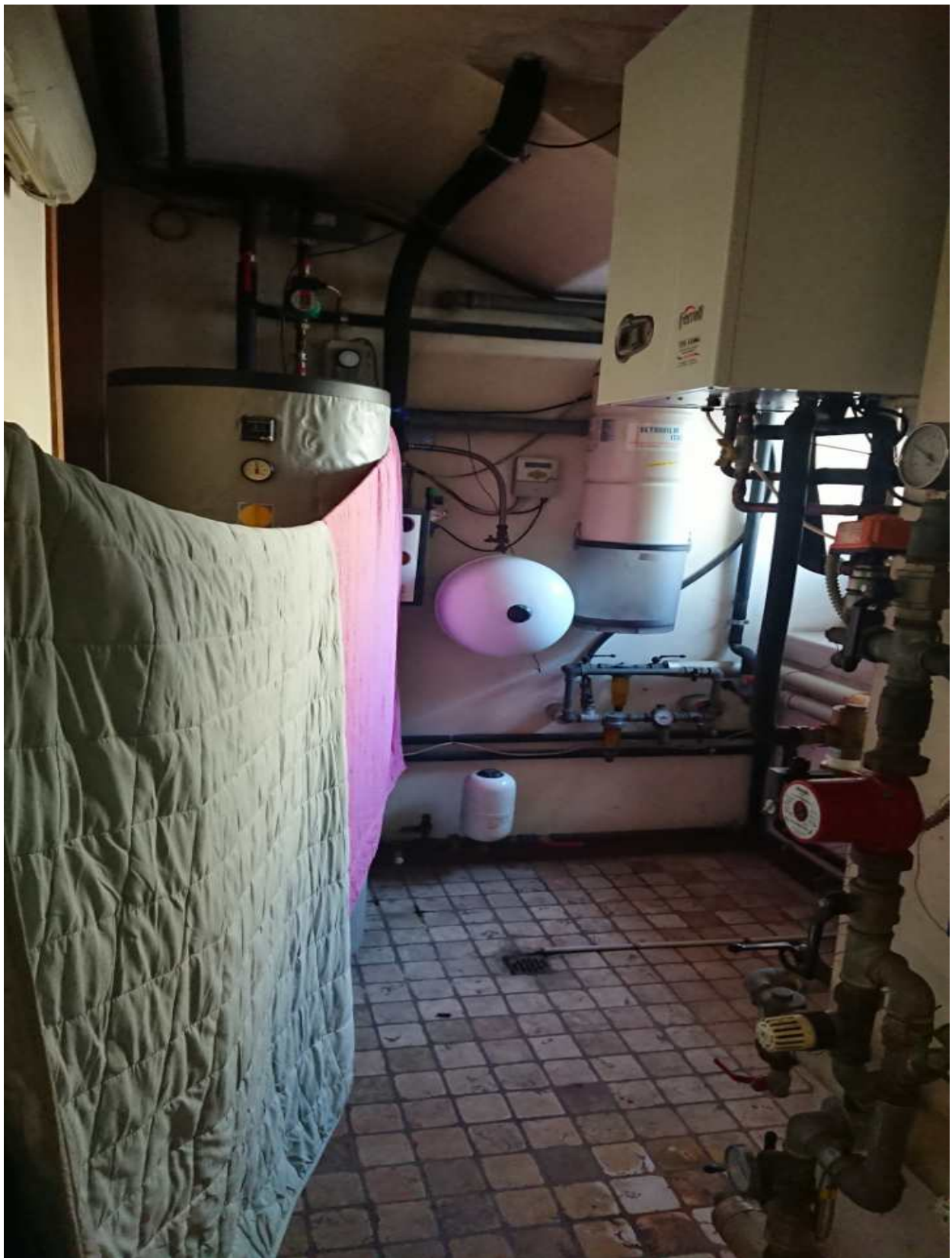
Foto n° 35 - Comune di Porcia, foglio 2, part.293 – Piano scantinato. Centrale termica.
