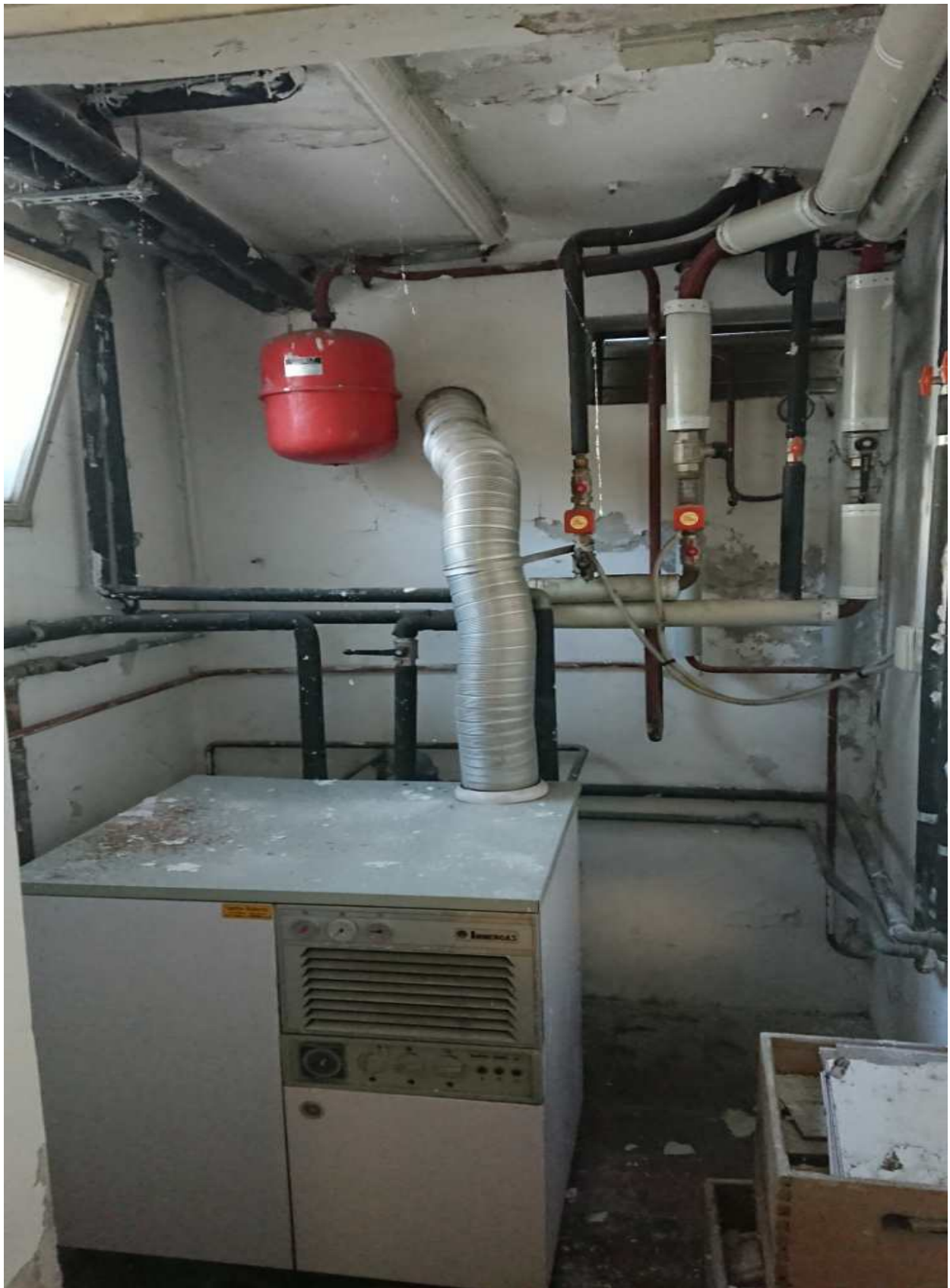
Foto n° 30 - Comune di Porcia, foglio 2, part.293 – Piano scantinato. Centrale termica.
