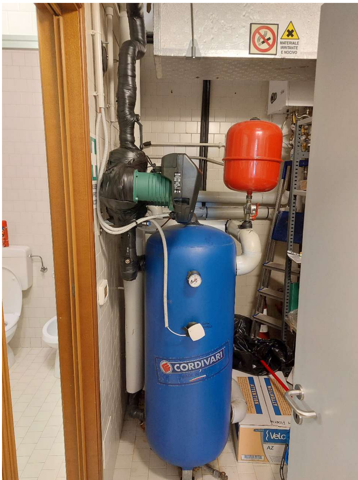
Foto n° 17 - Comune di Porcia, foglio 2, part.291, sub.22 – Centrale termica.
