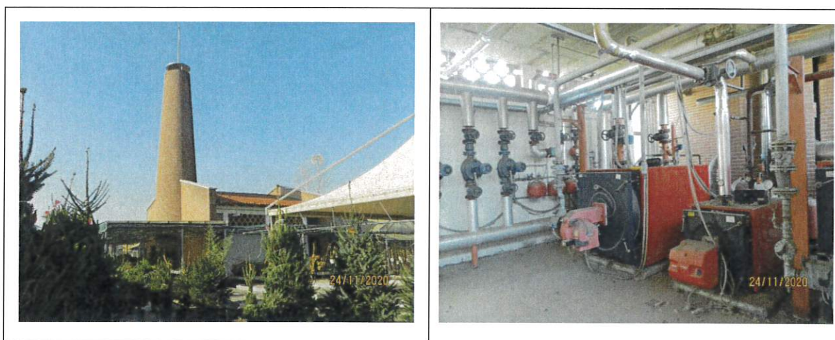
Centrale termica esterno
