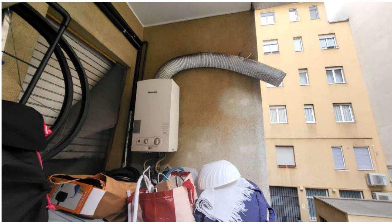
Dettagli – Scalda-acqua a gas metano
