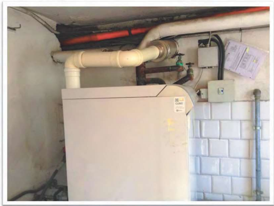
Particolare della caldaia e del vetro rotto dell'ingresso alla cantina.
