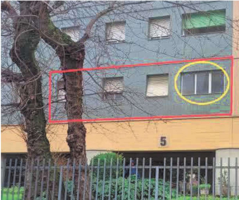
Vista del bene da via Marx n°5 con evidenziato abuso di entità minore
