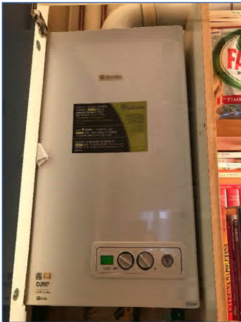
Foto 31 - dettaglio impianto termico
