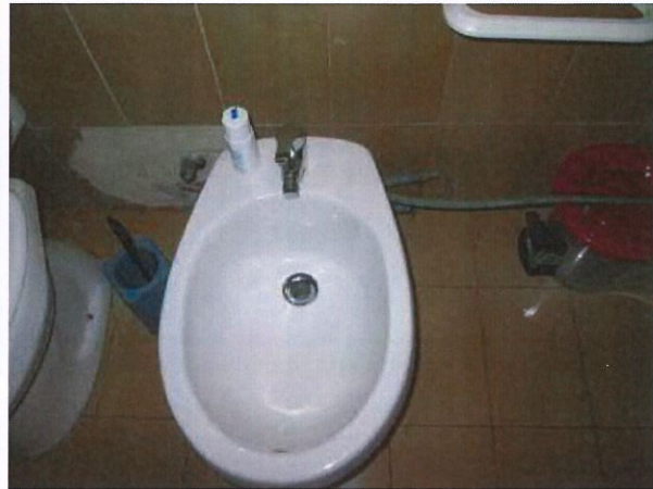
Scarichi apparecchi sanitari non conformi
