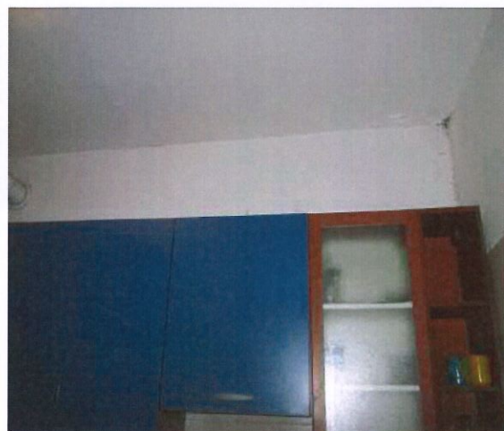
Non presente il foro per il collegamento con la cappa della cucina a gas
