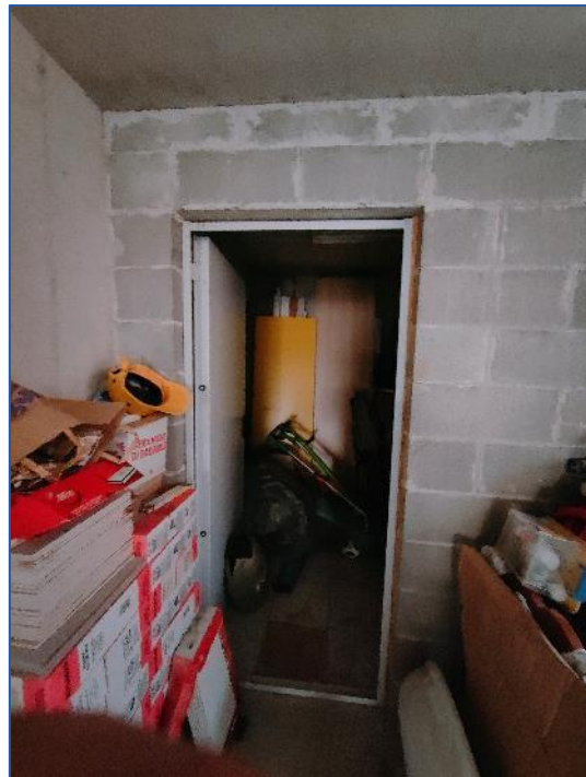
Foto 44 - porta collegamento box/cantina
