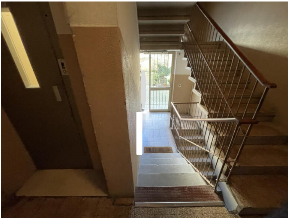
FOTO 3: MILANO, VIA MONTE POPERA 1, vano scala
