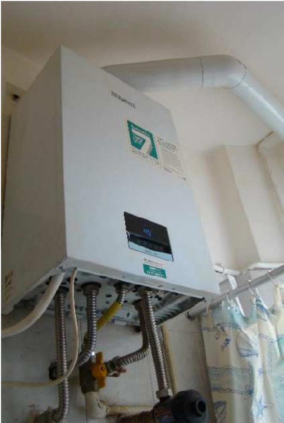
17. Dettaglio della caldaia.
