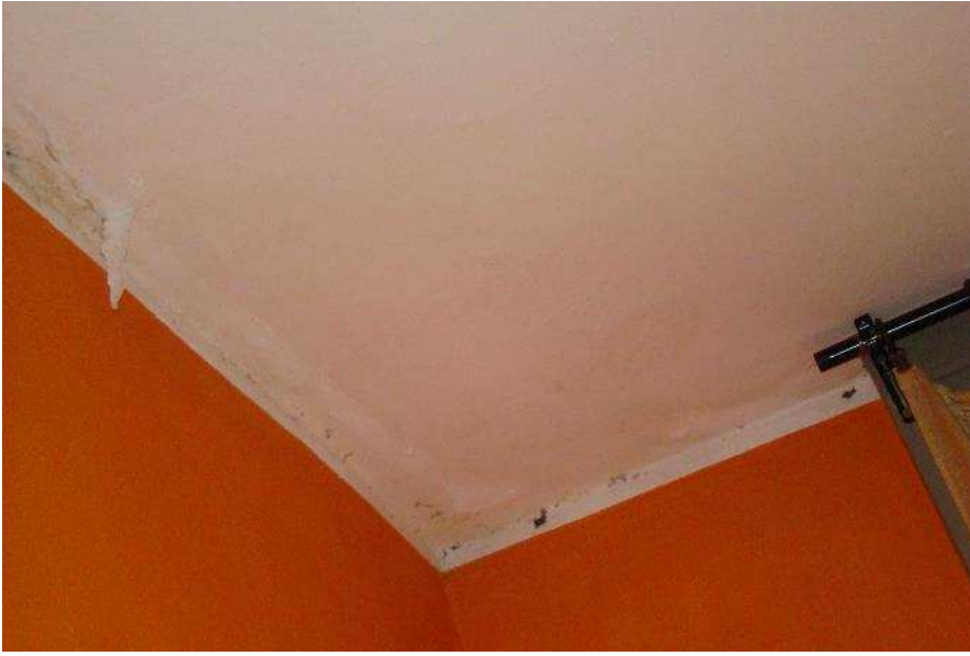
15. Dettaglio delle tracce di infiltrazioni nella camera.
