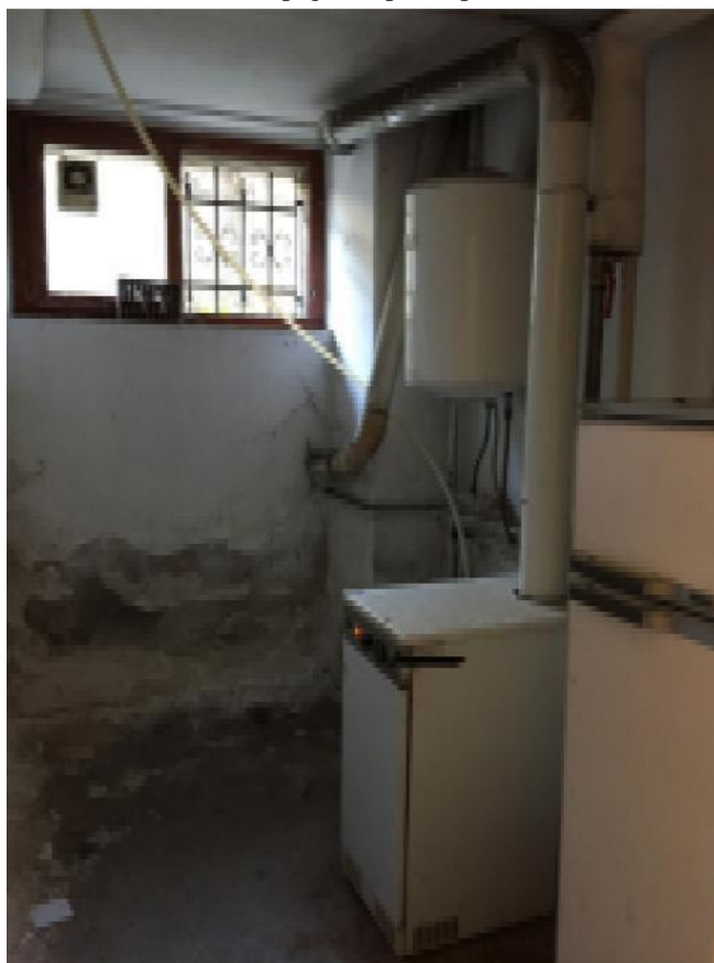
Foto 30 - Caldaia al primo piano interrato
