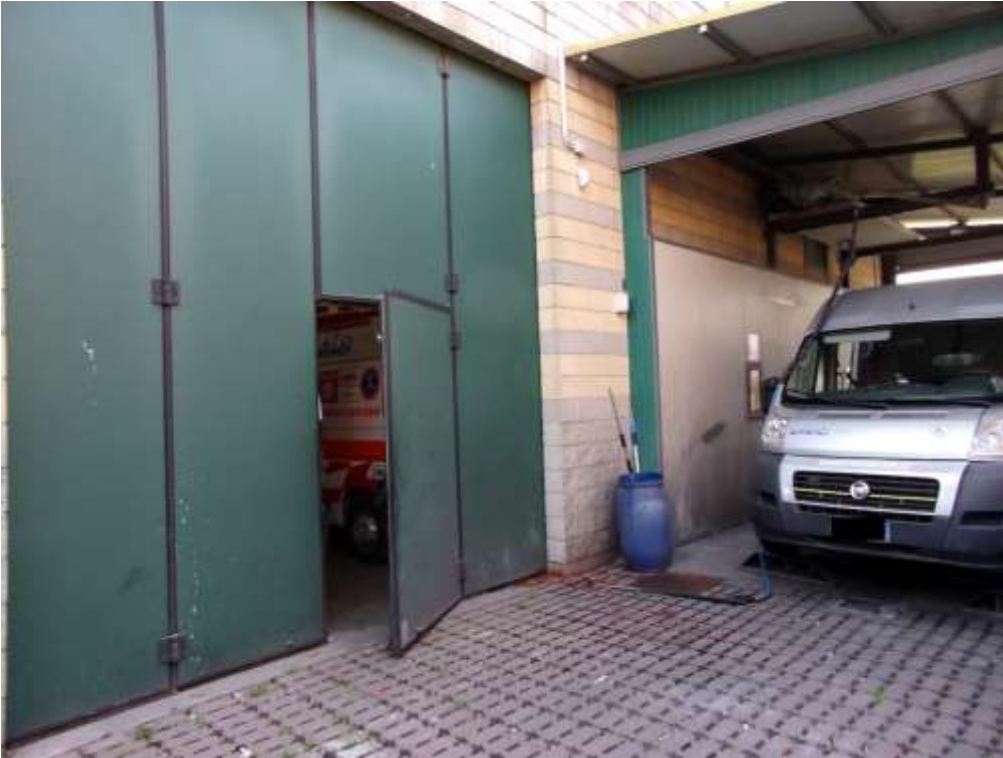
Foto 7: uscita posteriore dal cortile, sulla destra tettoia abusiva
