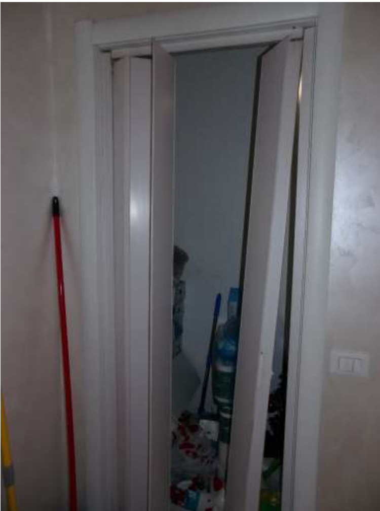
Foto 35: ripostiglio piano primo con porta a soffietto rotta
