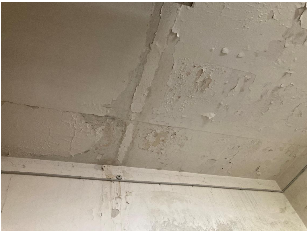
Foto n. 6: Dettaglio ammaloramenti a parete e a soffitto
