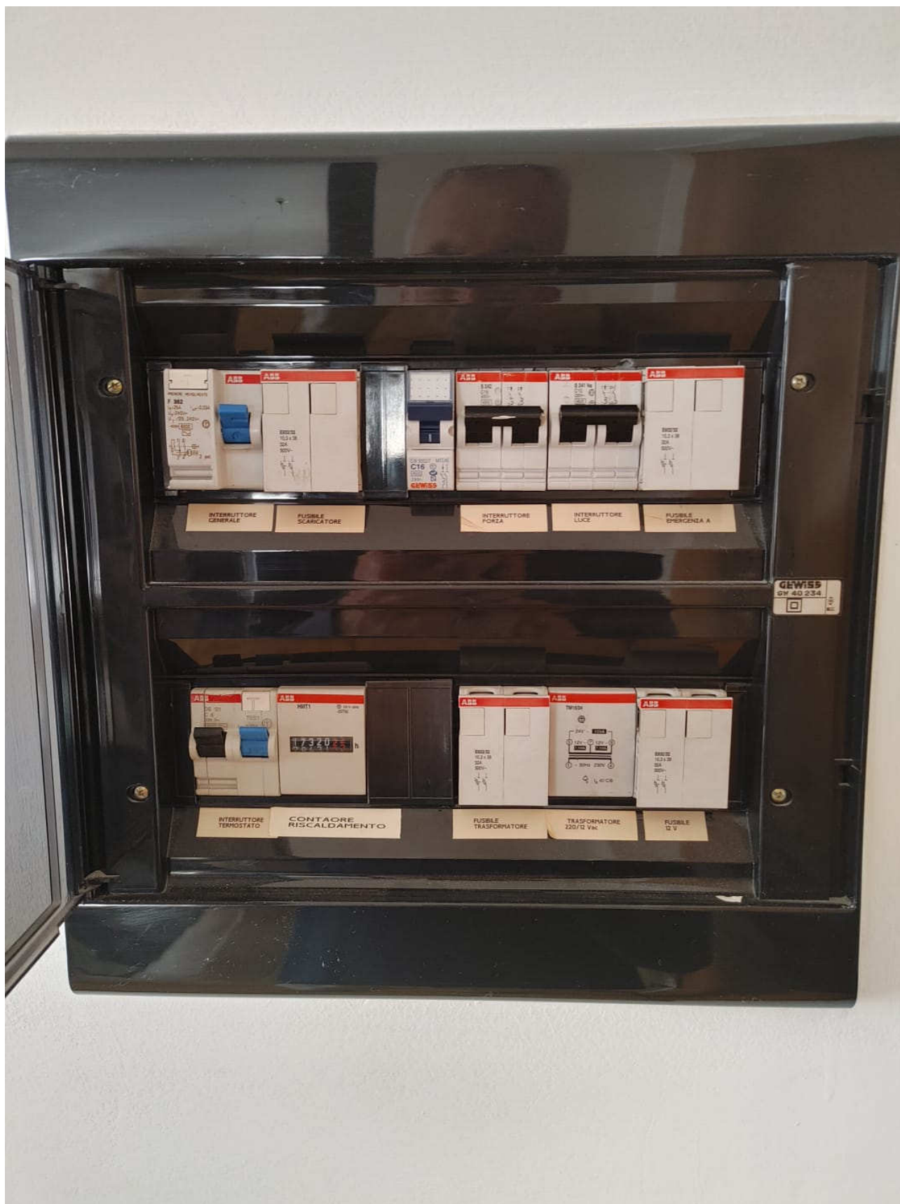
Foto 24 – particolare quadro elettrico appartamento
