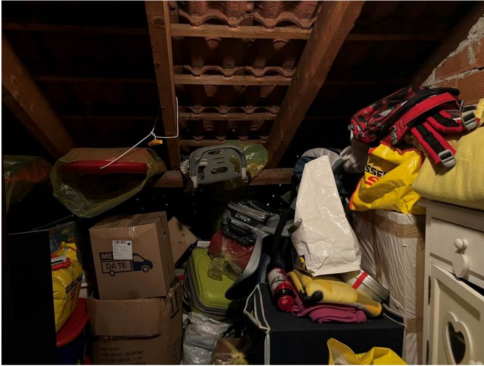
Fotografia n. 27 – Vista dell'interno del vano di solaio oggetto della procedura, con particolare della copertura
