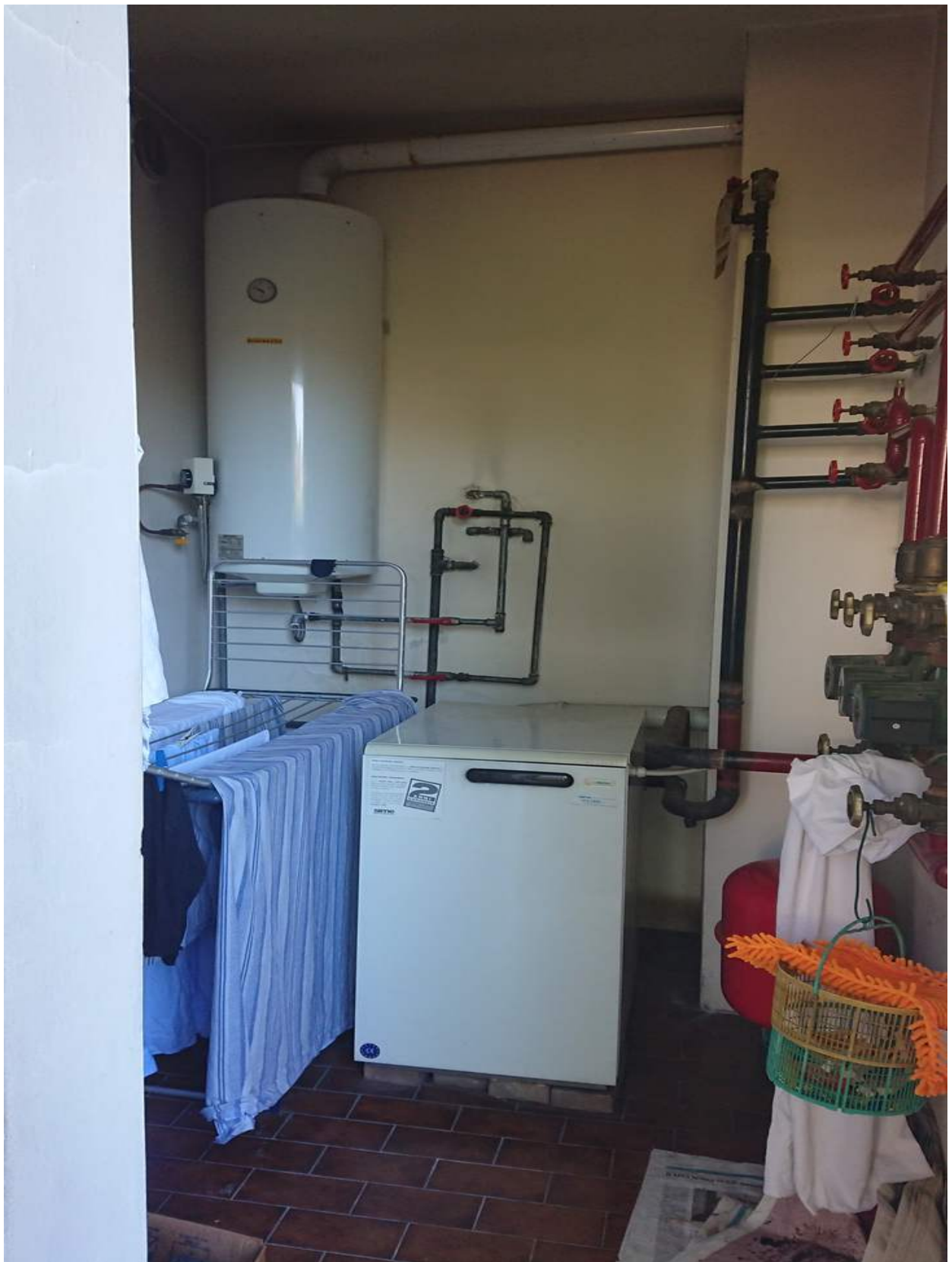
Foto n° 34 - 23/11/2021 - Comune di S.Stino di Livenza, foglio 13, part.432, sub.2 – Centrale termica.
