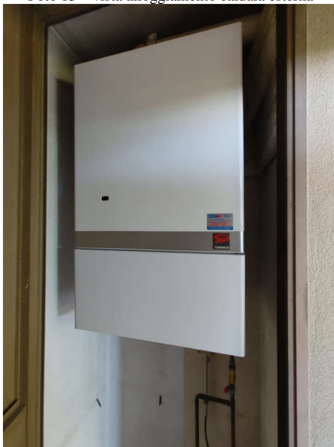
Foto 13 – vista alloggiamento caldaia esterna
