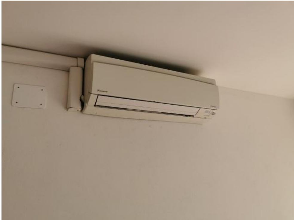
FOTO 27: UNITA' INTERNA CLIMATIZZATORE (Subalterno n. 5 – 1°P.)
