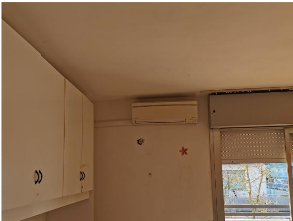
FOTO 26: UNITA' INTERNA CLIMATIZZATORE (Subalterno n. 5 – 1°P.)
