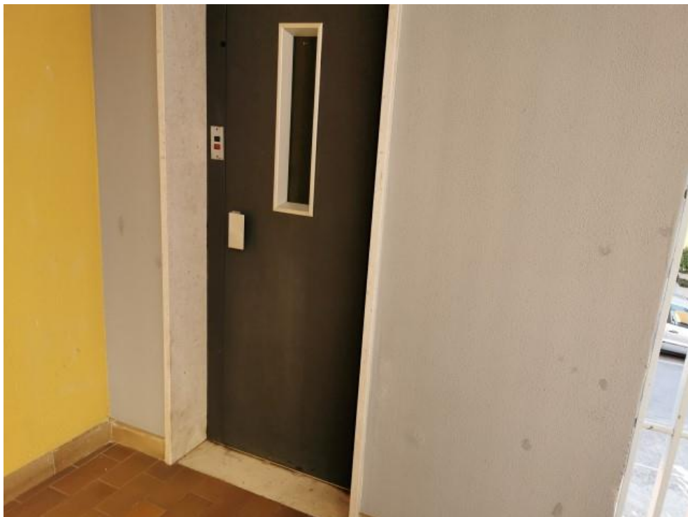
FOTO 10: ASCENSORE CONDOMINIO ELETTRA
