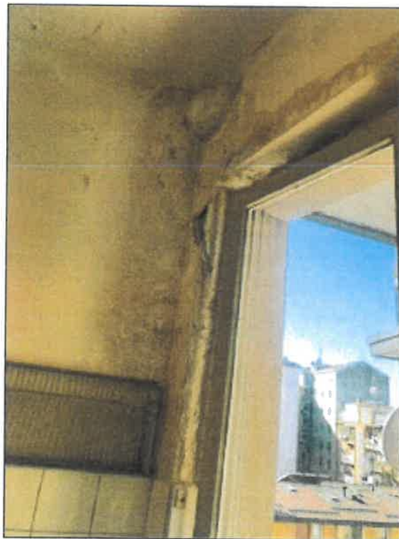
PARTICOLARE INFILTRAZIONI ANGOLO COTTURA
