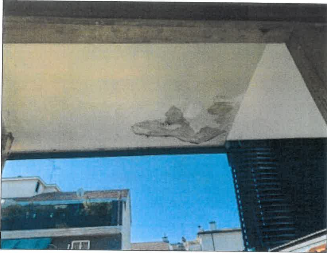
PARTICOLARE INFILTRAZIONI BALCONE
