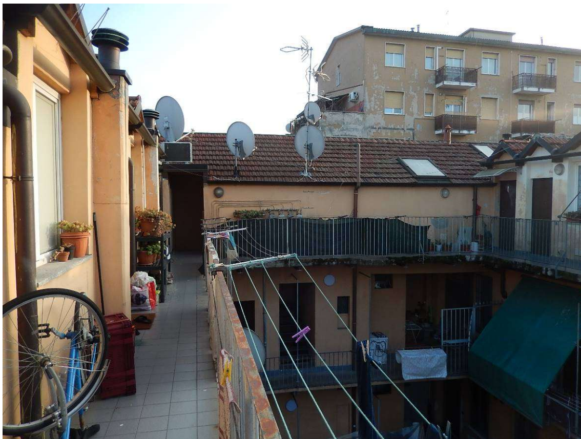
Foto 7 – Il ballatoio al piano terzo. A sinistra la finestra del bene in esame.
