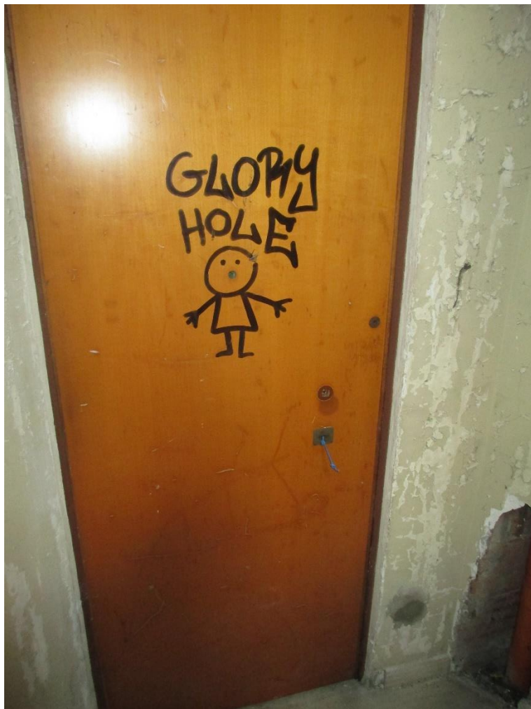
Foto 17: porta blindata forzata
