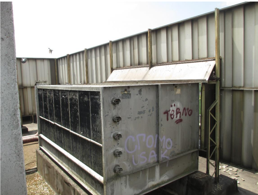
Foto 138: motori impianto meccanico sul terrazzo
