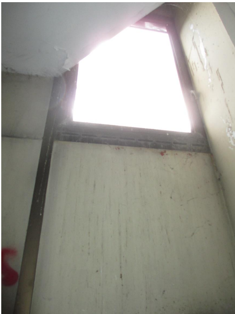
Foto 48: una finestra tra le tante che fanno filtrare l'acqua
