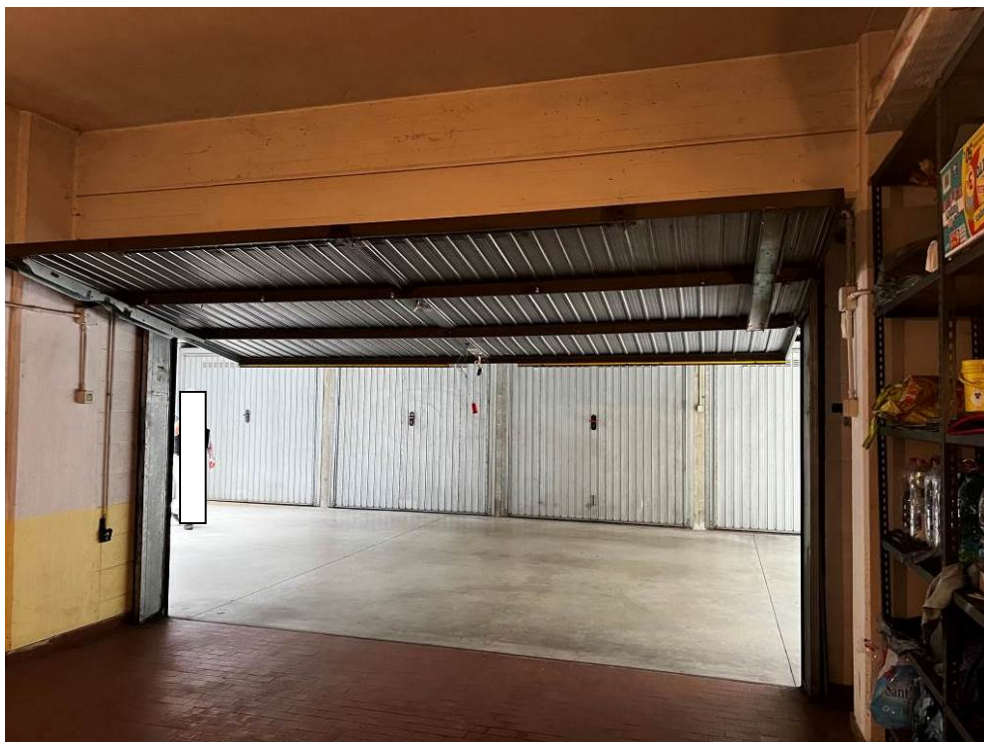
Fotografia n. 15 – Particolare della trave ribassata, posta sopra l'ingresso del box-garage, e a sinistra della parete di confine spostata verso l'esterno di circa 6/7 cm., così che la parete si trova su un'altro piano rispetto a quello del pilastro
