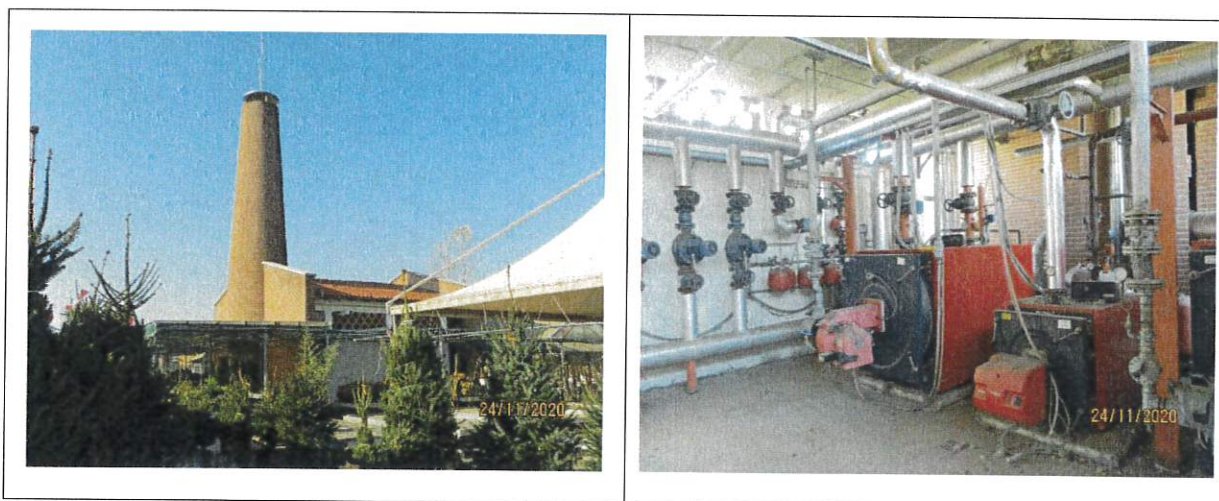
Centrale termica esterno
