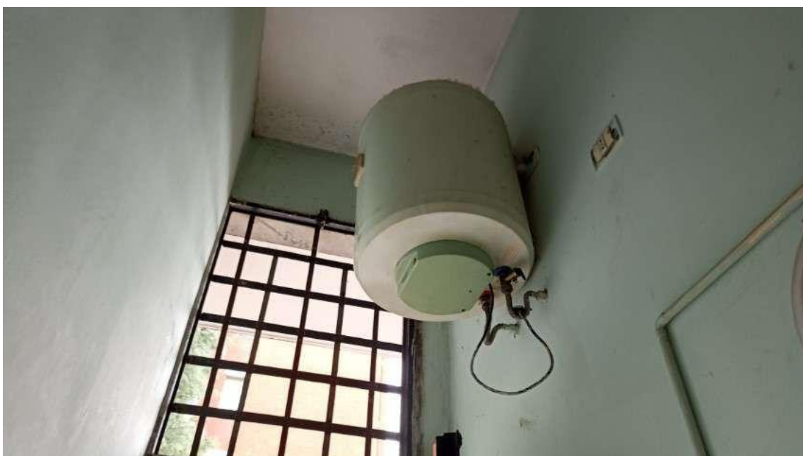
Foto n.12 – boiler elettrico per acqua calda sanitaria
