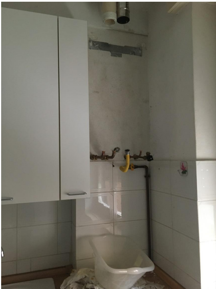
Foto 8: cucina manca caldaia
