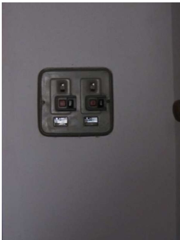
Dettagli – Quadro elettrico
