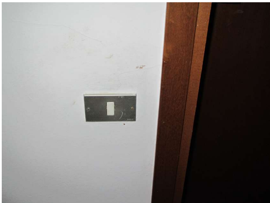
Dettagli – Impianto elettrico
