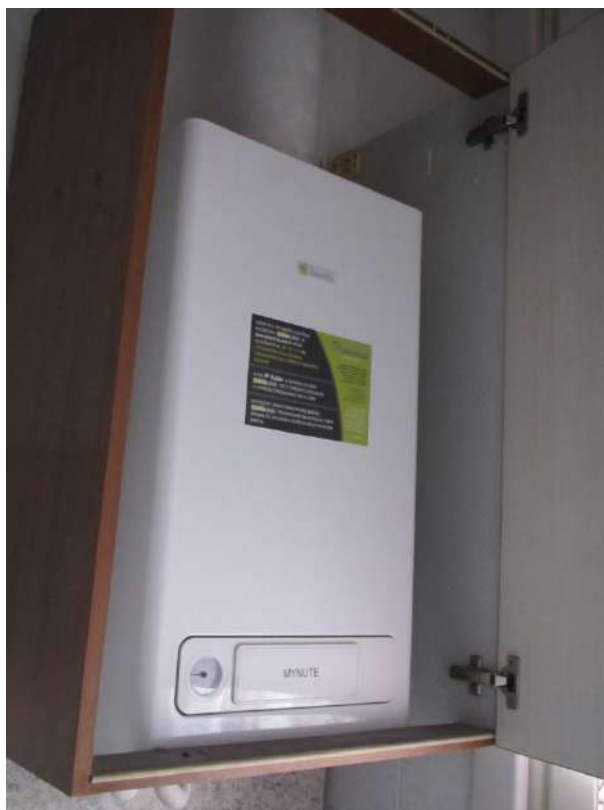
Caldaia autonoma per riscaldamento e produzione acqua calda sanitaria
