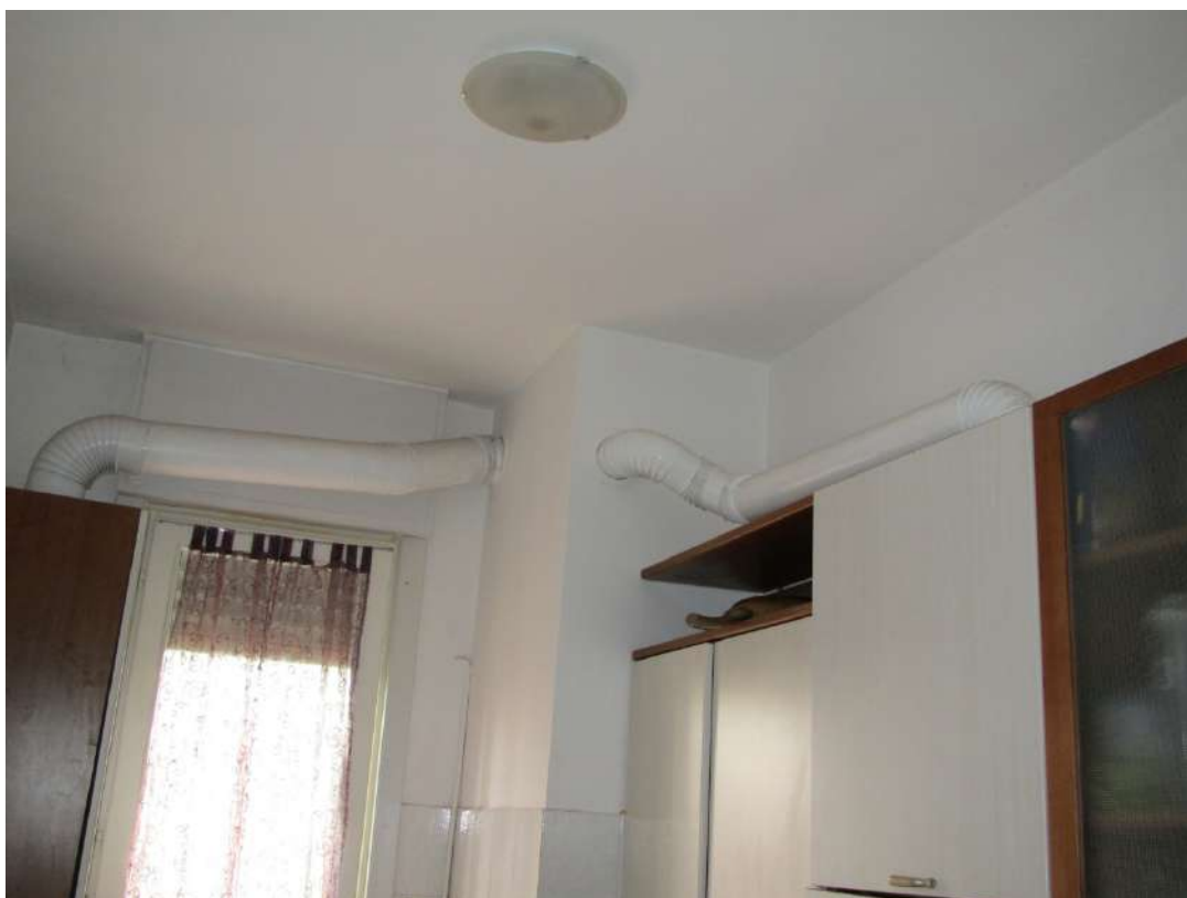
Dettagli - Canna fumaria della caldaia e tubazione di scarico della cappa aspirante
