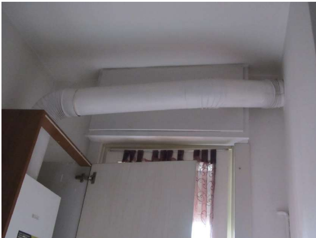
Dettagli - Canna fumaria della caldaia
