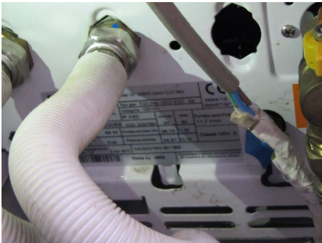
Dettagli - Impianto elettrico della caldaia
