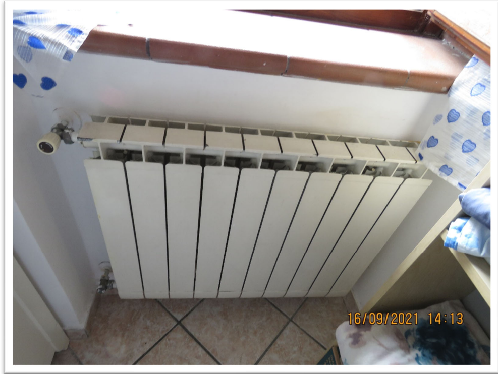
Particolari (termosifone e finestra del piano primo).
