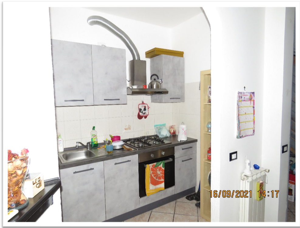
Particolari della zona cottura e della caldaia murale.
