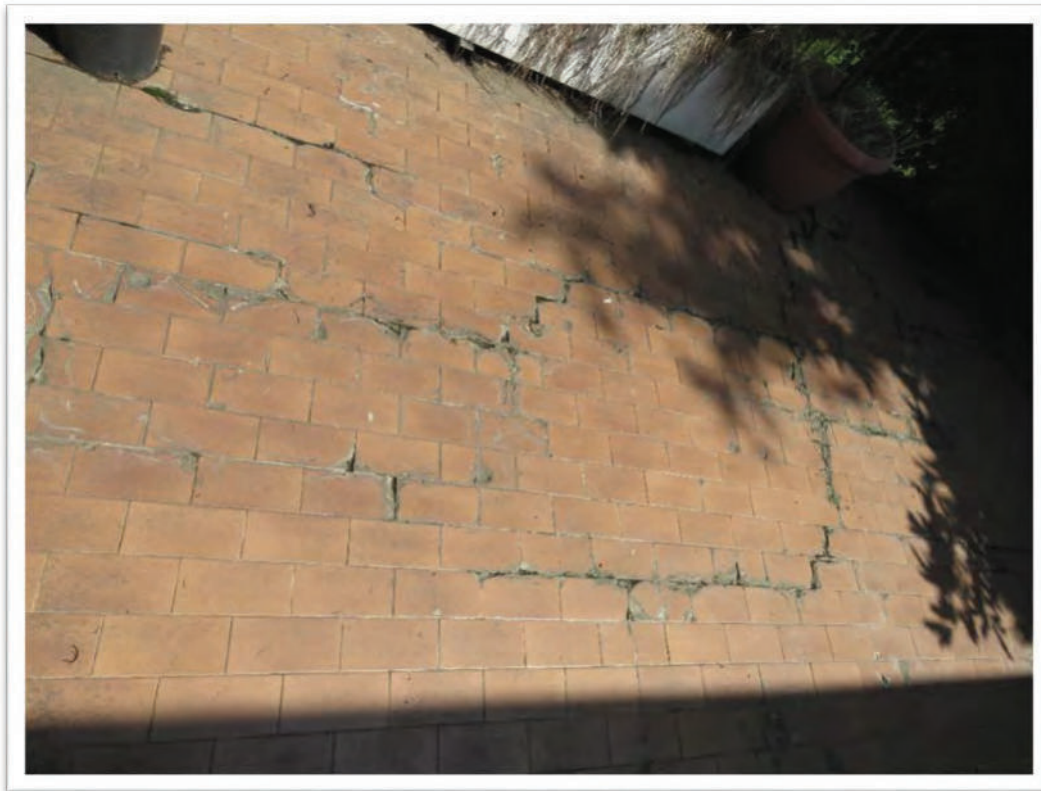
Particolari di degrado del terrazzo.
