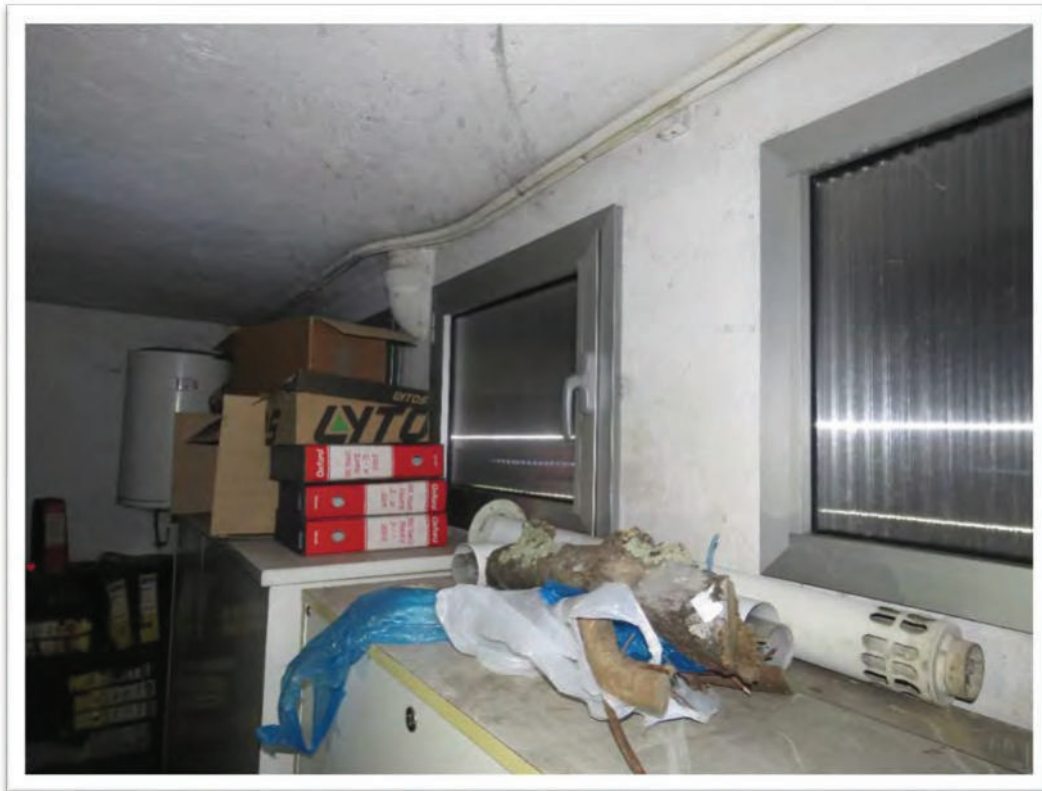
La cantina e la caldaia.
