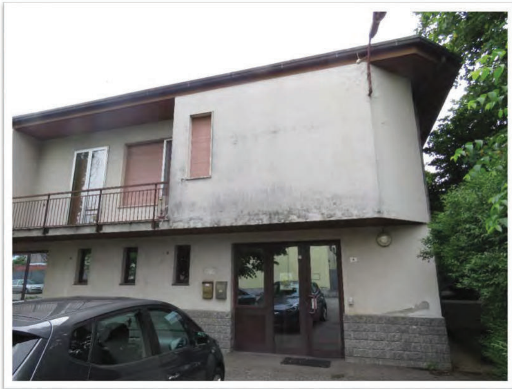
Particolare del fabbricato uffici/abitazione custode/cantina e vista del capannone da via Bologna. Da notare i pannelli solari posti sulla copertura .
