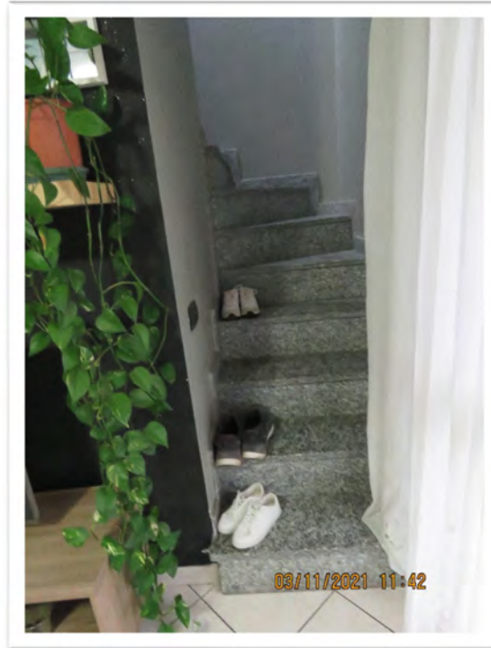
Scala interna a livello del seminterrato e vano cantina impropriamente utilizzato a soggiorno.
