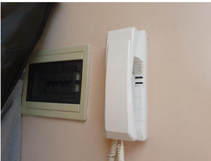
Quadro elettrico – citofono
