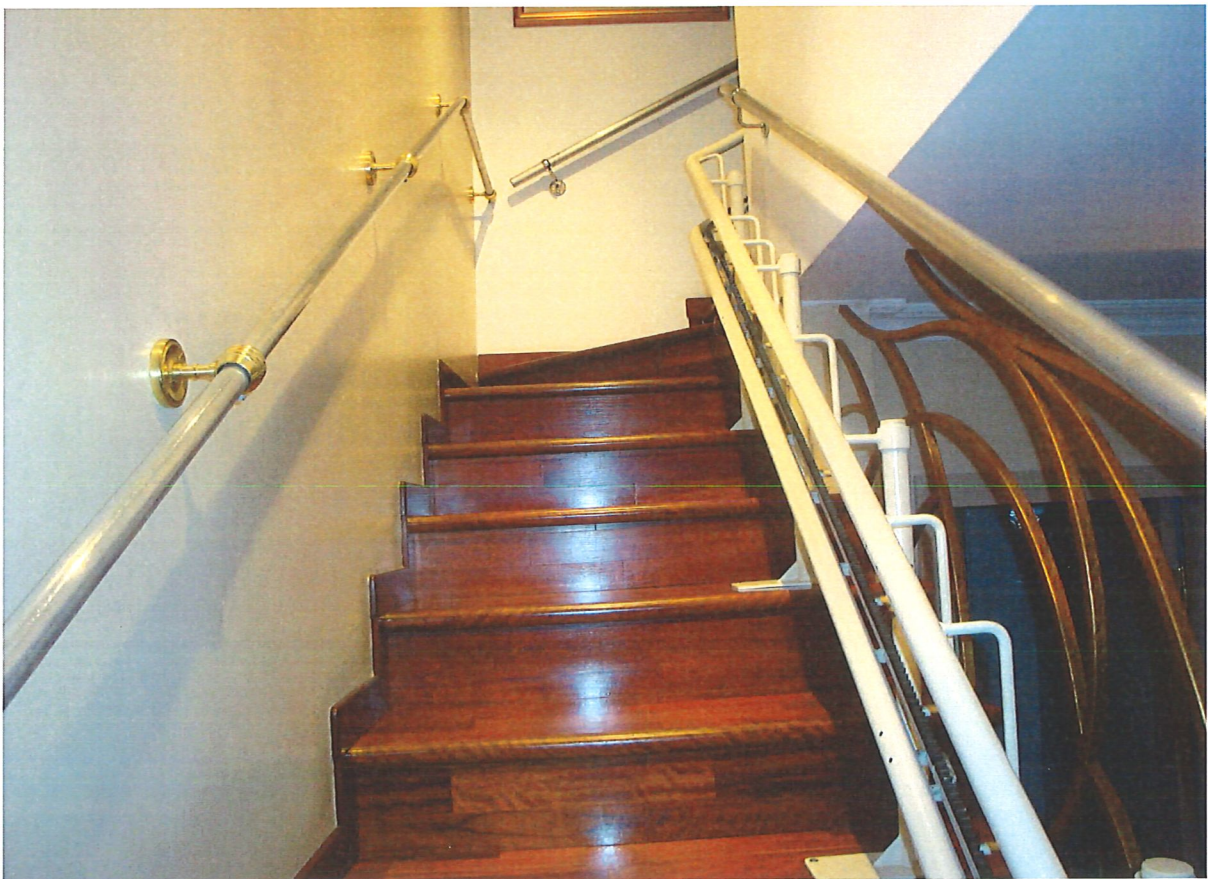
R.G.E. 388/2021 G. E. Dott.ssa M.G. Mennuni Gorgonzola, Via Per Cascina Antonietta n.°31, Foglio 12, mapp. 355, sub. 1 Prospetti interni: piano terra , la scala interna con servoscala
