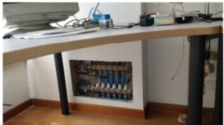
Vista delle predisposizioni per l'impianto di riscaldamento tradizionale a gas
