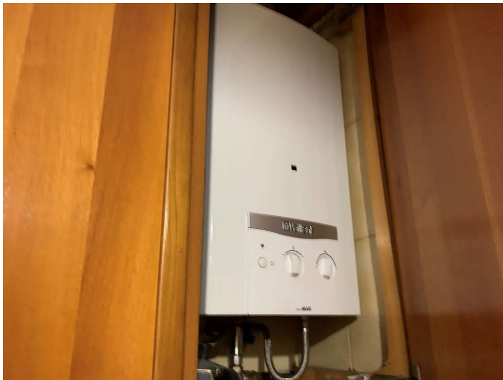
Fotografia n. 14 – Particolare dello scaldabagno a gas presente nel locale cucina
