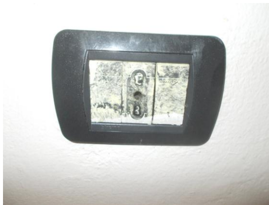
42. Dettaglio componente elettrica
