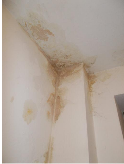
52. Infiltrazione nel bagno
