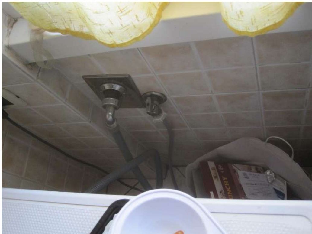
Mancanza del foro di aerazione permanente con griglia verso l'esterno
