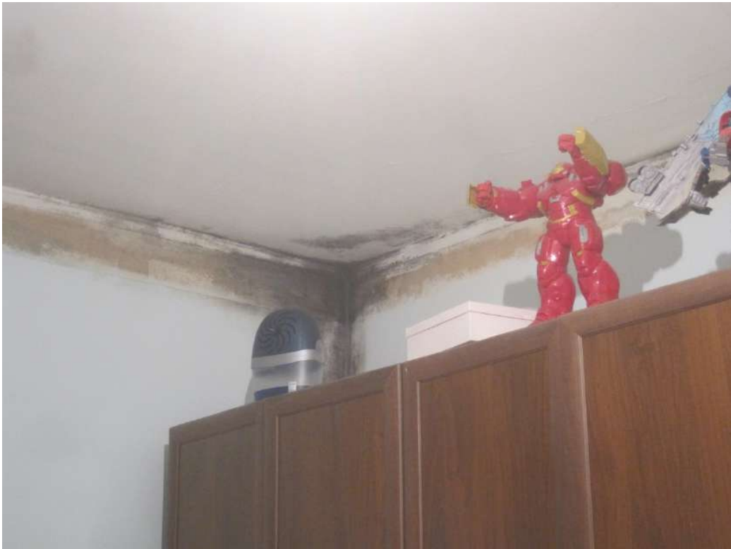
Dettaglio – Muffe in corrispondenza delle pareti Sud ed Est e del plafone
