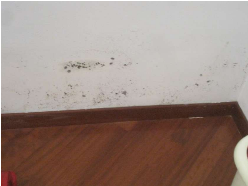
Dettaglio – Muffe in corrispondenza della parete Sud
