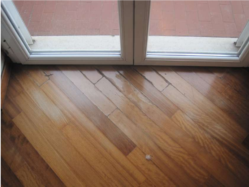
Dettaglio – Danni al pavimento in parquet
