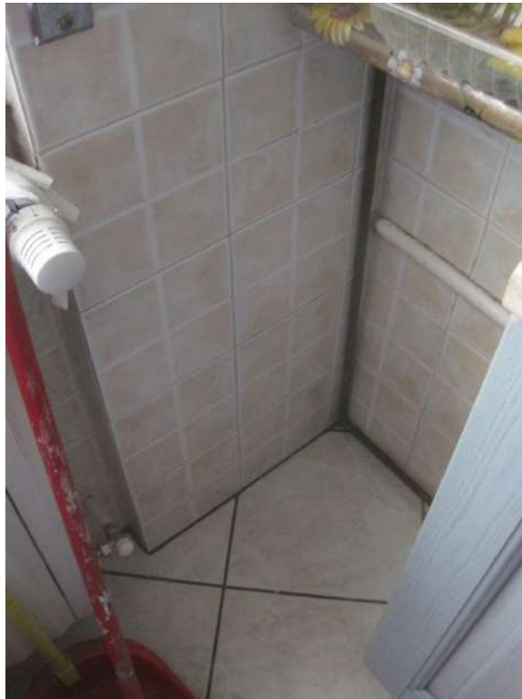
Mancanza del foro di aerazione permanente con griglia verso l'esterno
