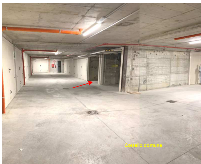
Foto nn. 11-12. Piano Secondo Interrato. Box auto (fg. n. 471 ptc. n. 413 sub. n. 27)
