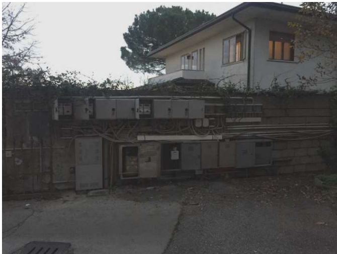
particolare della zona contatori elettrici e gas metano
