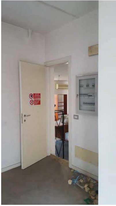
LOCALE TECNICO P1
